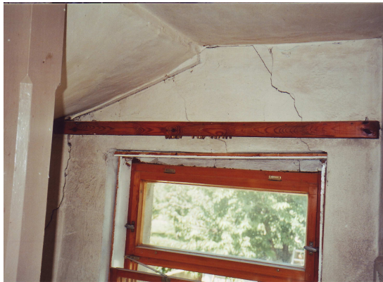
Bild 1: Die Last durch den Wangenbalken hat den gemauerten Fenstersturz vollständig zerdrückt.
