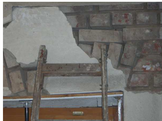
Bild 2: Sehr deutlich ist der Bruchverlauf in den Mörtelfugen des gemauerten Fenstersturzes zu erkennen. Einzelne Steine sind bereits herausgefallen.
